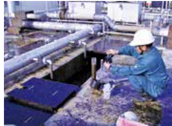
大規模浄化槽の保守点検業務。
